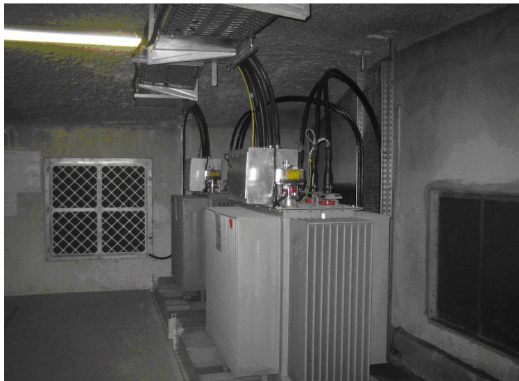
Vue de l'installation des deux transformateurs 800 kVA (poste de livraison)
