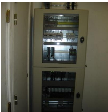
Baie de contrôle
