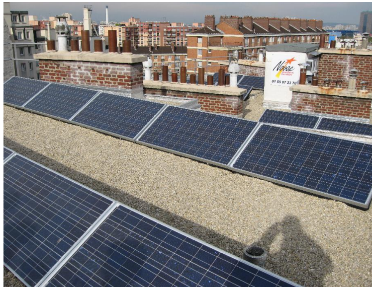
Vue d'une partie de l'installation en toiture
